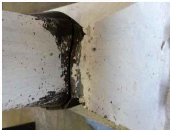
Figura 71. Daños observados en el ensayo experimental 1 de la conexión CX-1.
