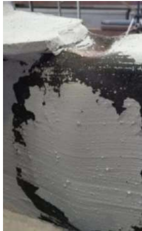
Figura 75. Daños observados en el ensayo experimental 3 de la conexión CX-1.
