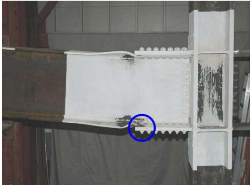
Figura 93. Ubicación de la fractura en la conexión CX-3.
