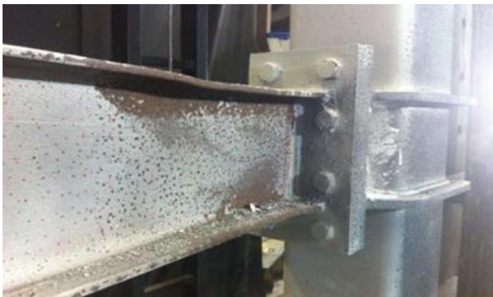
Figura 84. Daños observados en el ensayo experimental 2 de la conexión CX-2.
